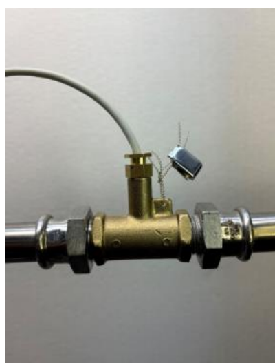
Figure 6 - Meter sealing done by the installer Figura 3 – Sigillatura del contatore effettuata dall'installatore
